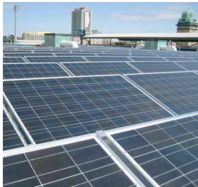
Смонтированная на крыше 100 кВт фотоэлектрическая установка на выставочной площади, Торонто, Онтарио, Канада
